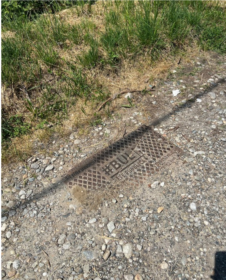
Figura 30 – chiusino della fibra ottica interrata
